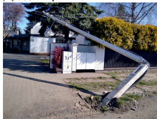
Najnowsze uszkodzenie udokumentowano 2 kwietnia br. W słupy energetyczne wjeżdżają regularnie śmieciarki, samochody osobowe i dostawcze, a mieszkańcy są wówczas odcięci od prądu. (K) Fot. Czytelnik Michał
